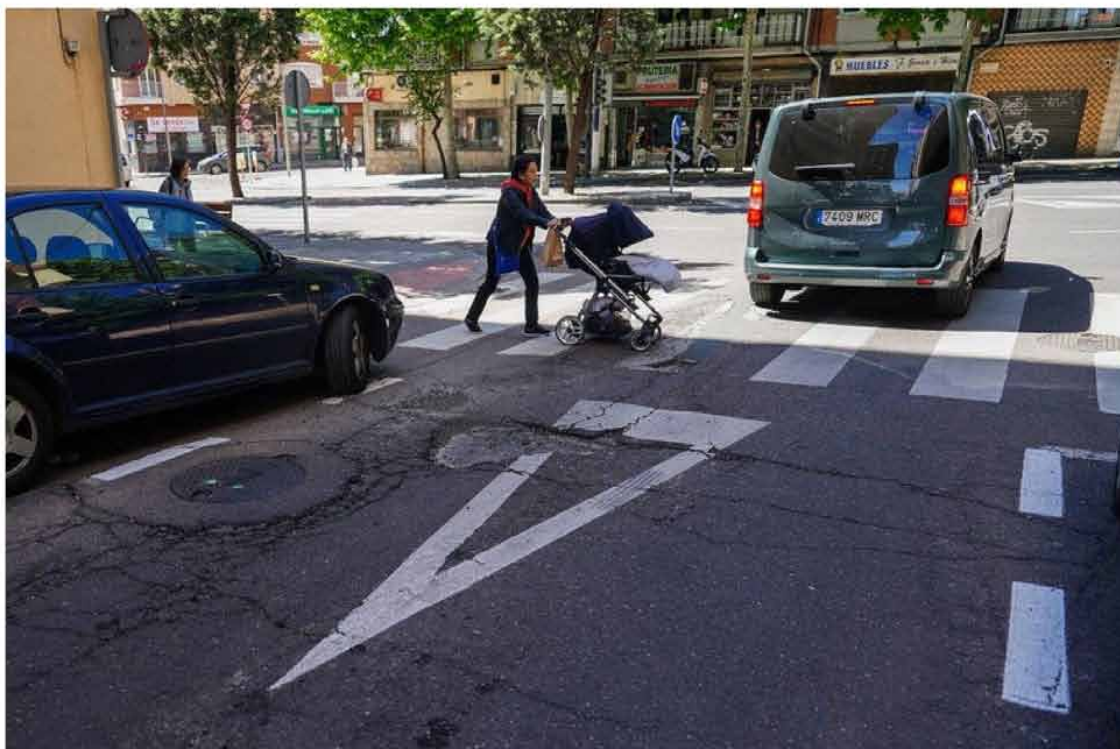
La calle Fresno, parcheada a causa de los reventones. LAYA
