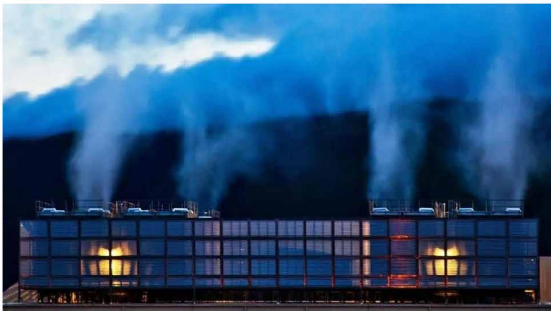
Centro de datos de Google en Oregon (EEUU) refrigerado mediante torres de refrigeración.
